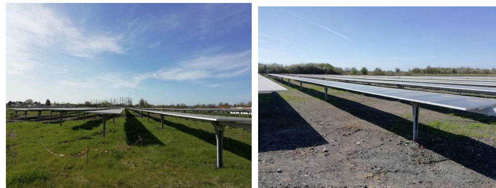
Photo 5 : Suiveurs à rotation mono-axiale (Site SNCF de Surdon – Château d'Almenêches, une réalisation IEL)
