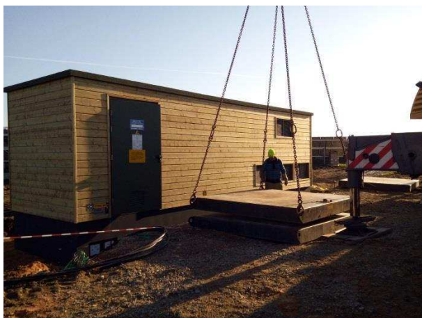
Photo 7 : Exemple d'un poste de livraison (photo prise en phase chantier Source : IEL)
