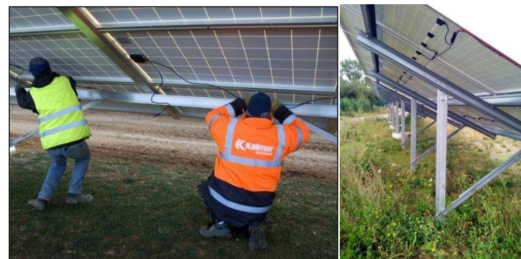
Photo 11 : Câblage des panneaux photovoltaïques
