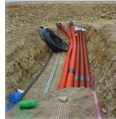
Photo 19 : Câblage sur site entre les postes électriques (Source : IEL)
