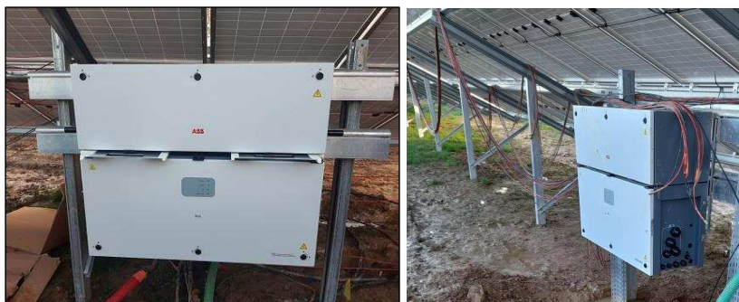
Photo 14 : Onduleurs fixés sur les structures photovoltaïques (Ferme Solaire de Beauvoir, photos prises en phase construction, IEL)
