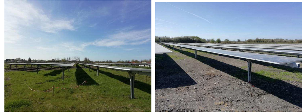
Photo 5 : Suiveurs à rotation mono-axiale (Site SNCF de Surdon – Château d'Almenêches, une réalisation IEL)
