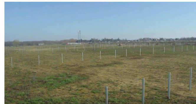
Photo 13 : Mise en place des pieux battus - photos de la construction de la Ferme Solaire Marc Energies, une réalisation IEL
