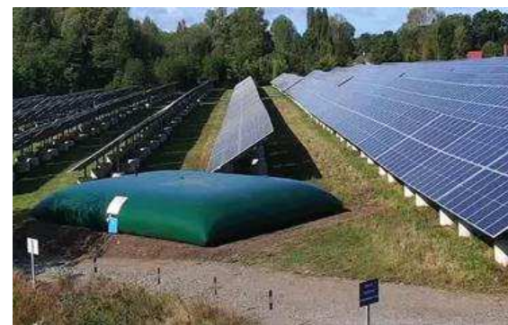
Photo 18 : Citerne incendie 60 m3 de la centrale photovoltaïque au sol du Gravier à Aubigné-Racan (72), une réalisation IEL
