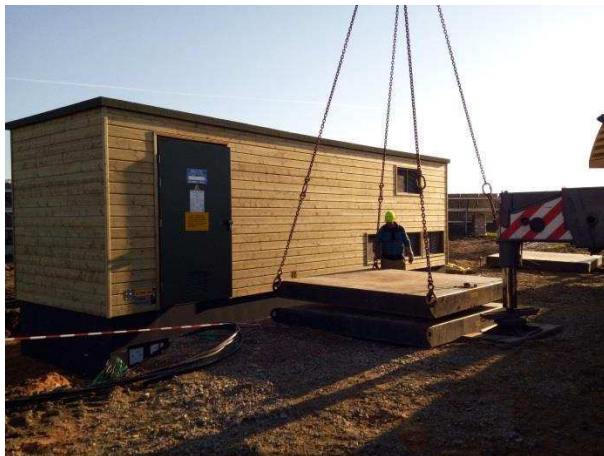
Photo 7 : Exemple d'un poste de livraison (photo prise en phase chantier Source : IEL)
