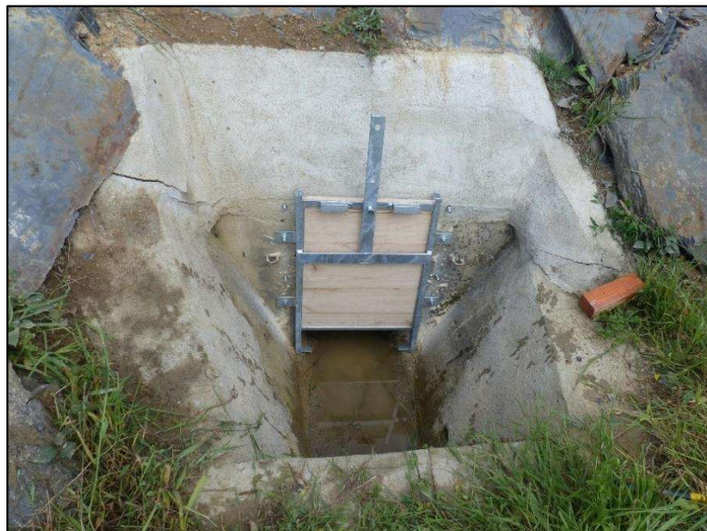
Photo 18: Ouvrage de temporisation mis en place à Congrier en 2019– Source : Syndicat du Bassin de l'Oudon
